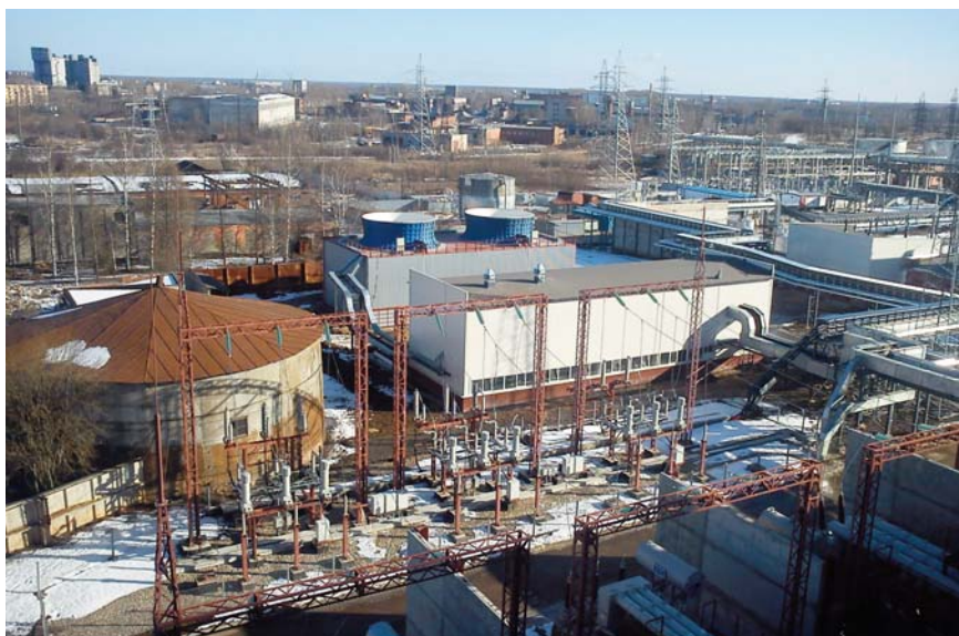
Открытое распределительное устройство (ОРУ-110)
